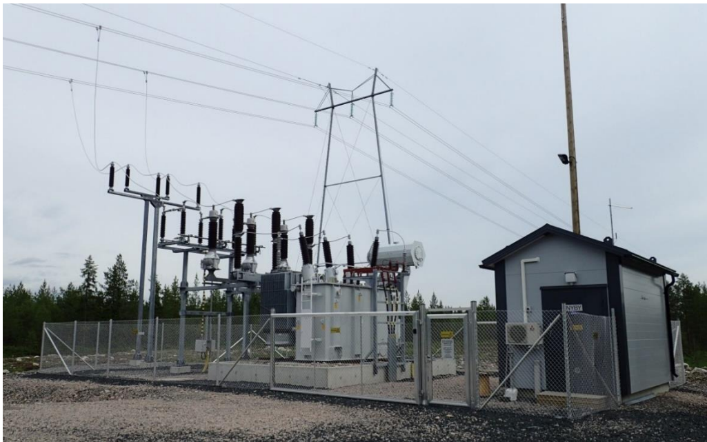
Kuva 98. Esimerkki tuulivoimahankkeen sähköasemasta (Minna Takalo, FCG).
