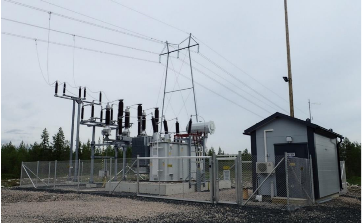
Kuva 97. Esimerkki tuulivoimahankkeen sähköasemasta (FCG).
